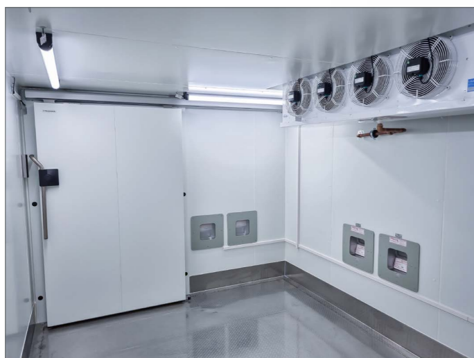
Schleuse mit aktiver – 20 °C Kühlung
